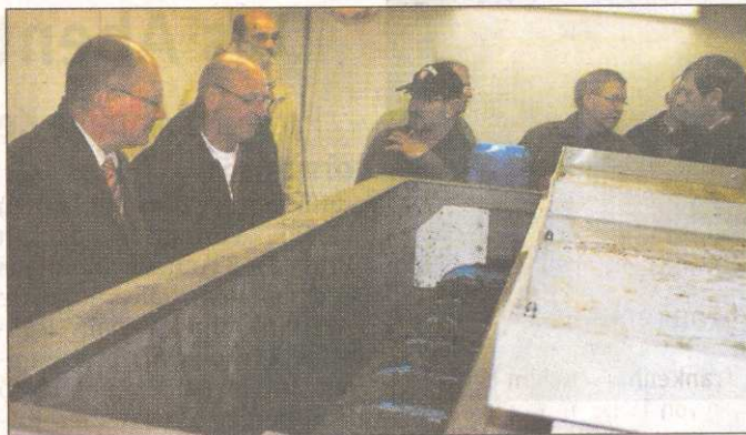
Auch die neue Schlammeindickungs- und -entwässerungsanlage wurde bestaunt.
