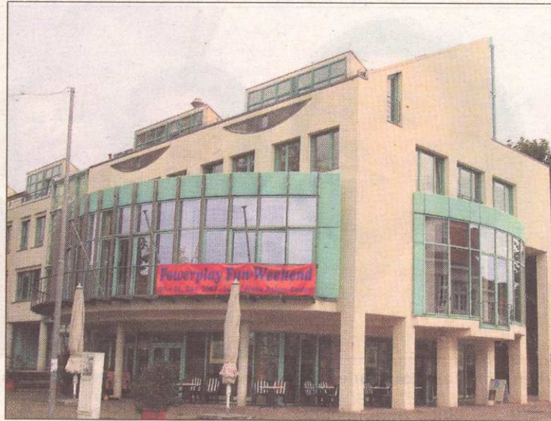
14 Jahre nach dem Bau werden am Rathaus jetzt Reparaturen in Höhe von mindestens einer halben Million Euro nötig. Foto: Hirsinger
