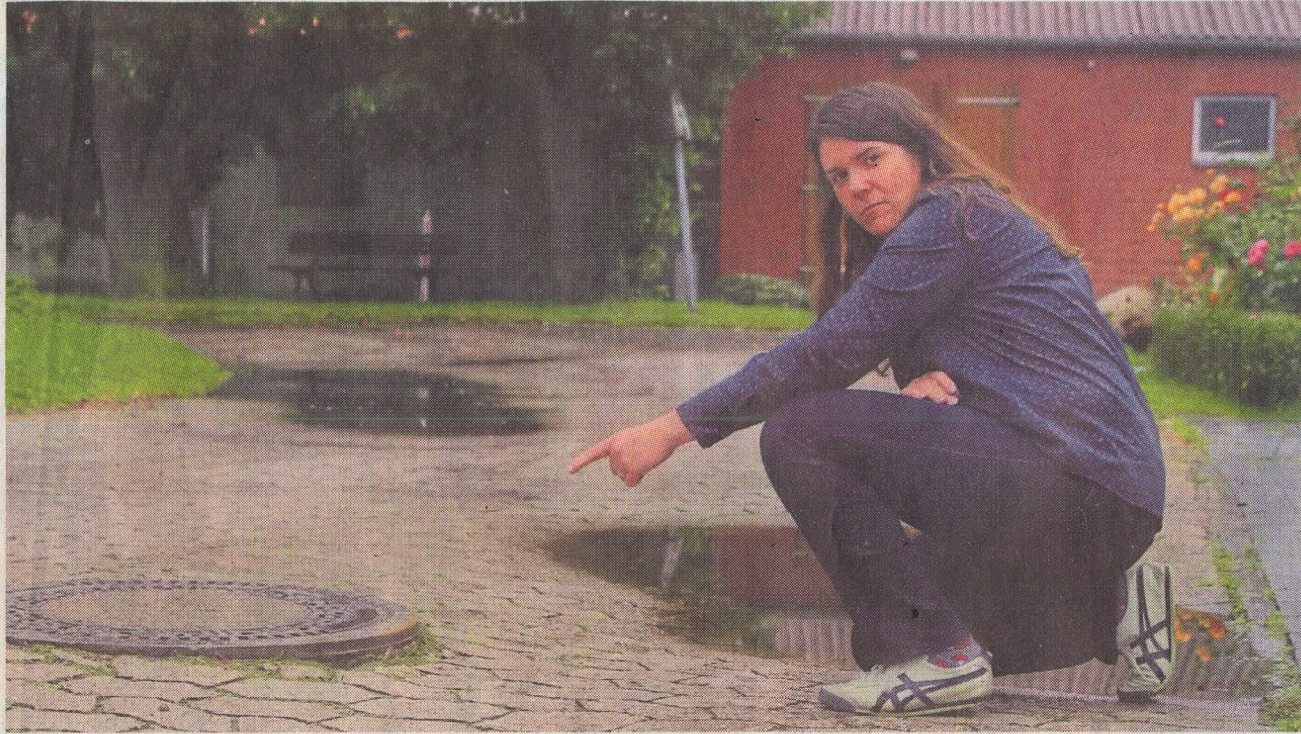
Herausstehende Gullydeckel, Pfützen und mehr: Maren Elfers macht auf die Missstände am Beekenende aufmerksam.
