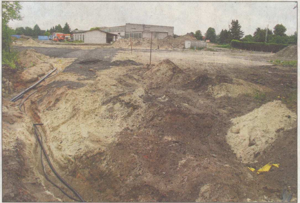
Die Erschließung des neuen Wohn- und Gewerbegebietes ist in vollem Gange. Die Industriebrache in der Uphuser Ortsmitte verschwindet. - Foto: Brodt
