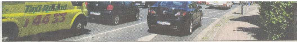
Nächste Woche wird die Baustelle an der Gieschen-Kreuzung eingerichtet. Ende Juni sollen die Bauarbeiten für den Kreisell mit dem Abriss der Häuser links und rechts beginnen. In drei Monaten soll der Kreisell gebaut sein. Kosten soll er 1,1 Millionen Euro.
