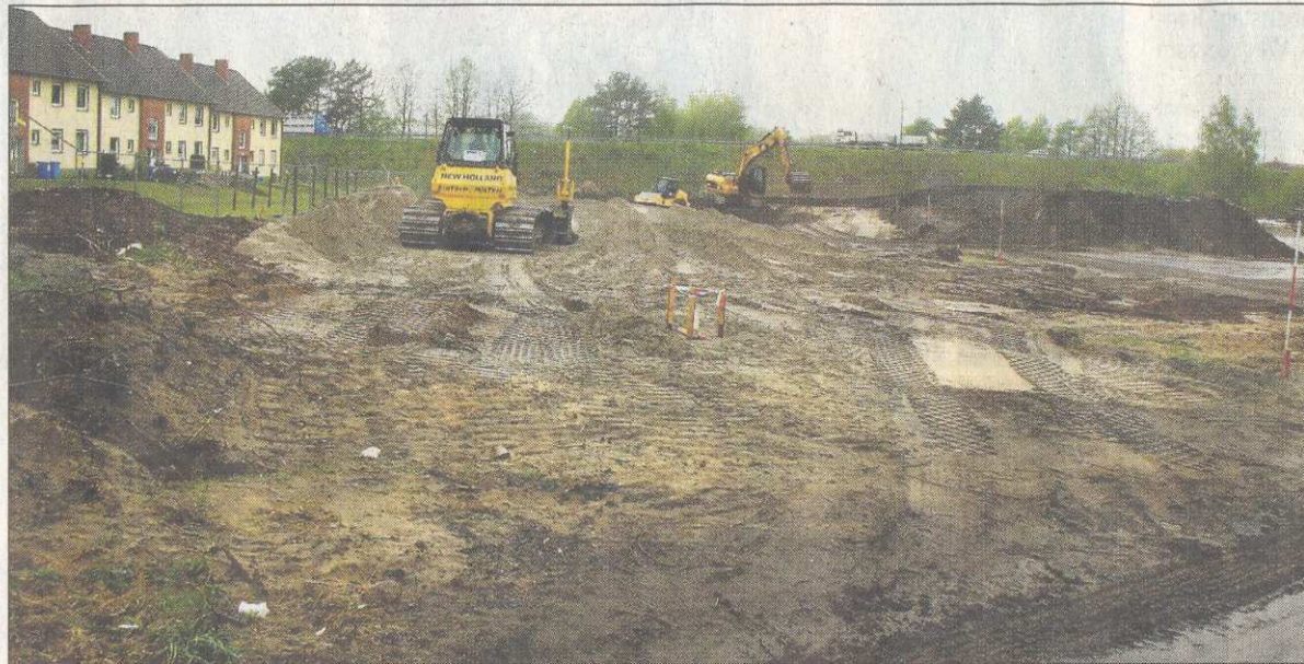
Auch die neue Zufahrtsrampe von der Höhe der L 156 zum Ex-Kasernengelände wird 2010 „gestemmt“. Die Arbeiten haben begonnen.
