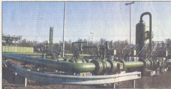
Gas aus drei eintreffenden Leitungen wird verdichtet in vier Leitungen weitergeleitet.
