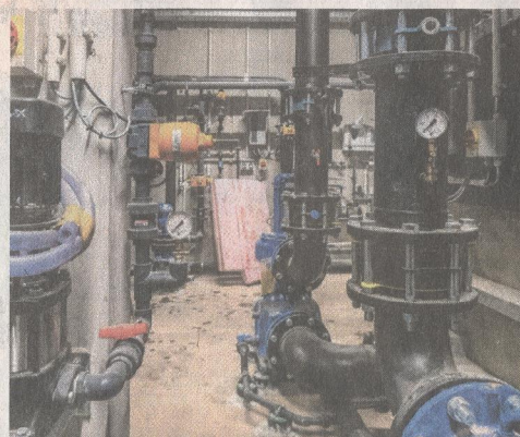
Für den Sprayground und das Babybecken gibt es einen eigenen Technikraum.
