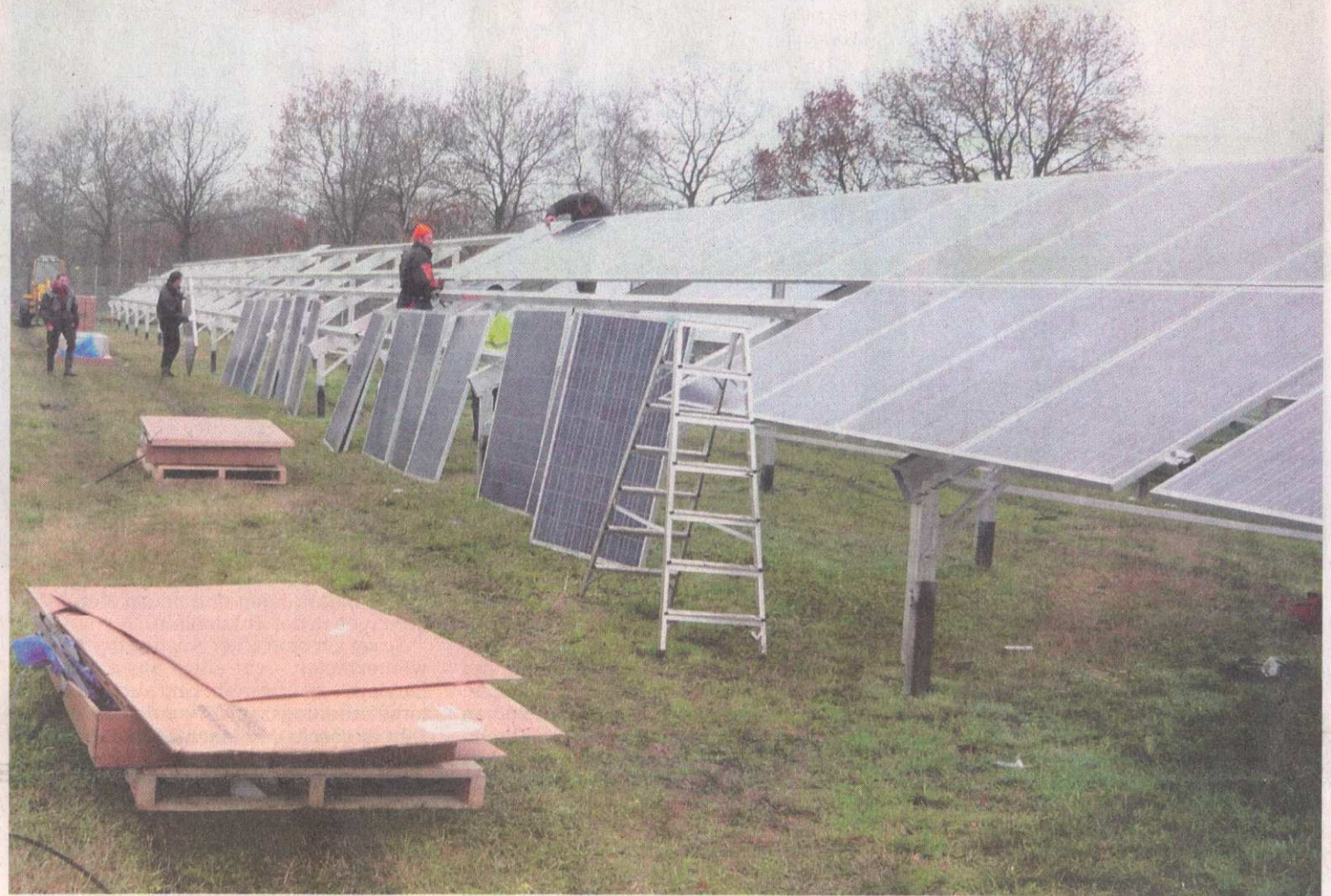
Dieses Beispiel zeigt, was bald auch auf der Fläche der ehemaligen Raketenstation zwischen Embesen und Oyten zu finden sein wird: ein Photovoltaikpark. Dafür werden Ständer in den Boden gerammt, darauf dann Solarmodule installiert. Die Firma Bematec aus Aurich hat nach eigenem Bekunden einen Nutzungsvertrag über 20 Jahre mit dem Grundeigentümer abgeschlossen inklusive einer Option auf weitere fünf Jahre. FOTO: BEMATEC
