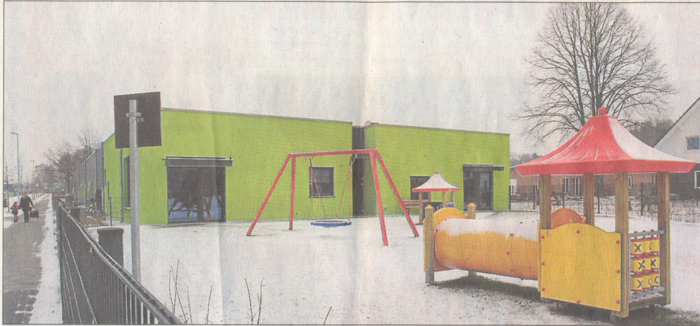
Heute wird an der Kindertagesstätte an der Steubenallee 12 noch einmal nach der Ursache des Schimmelpilzbefalls gesucht. ■ Foto: Idu
